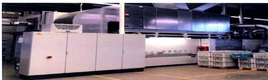
Abbildung 3 Lackierautomat mit Wärmerückgewinnung
